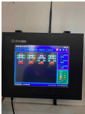
油气回收监测系统
