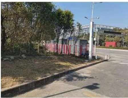
西北面室外变压器
