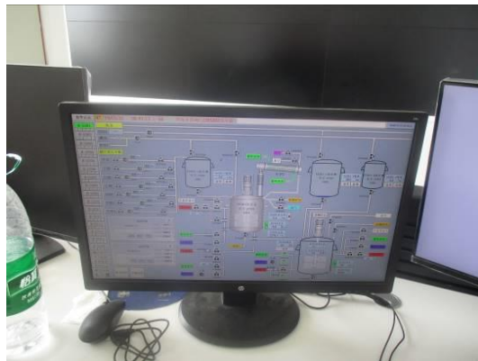
图6 PLC 控制系统
