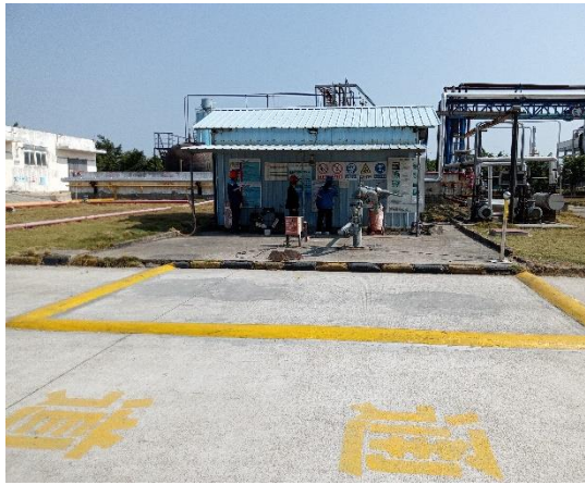
苯乙烯罐组万向管道卸车系统
