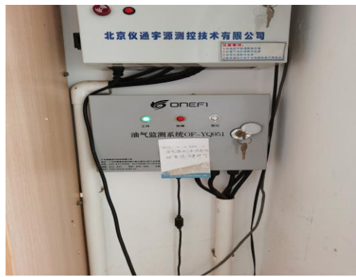
测漏报警系统
