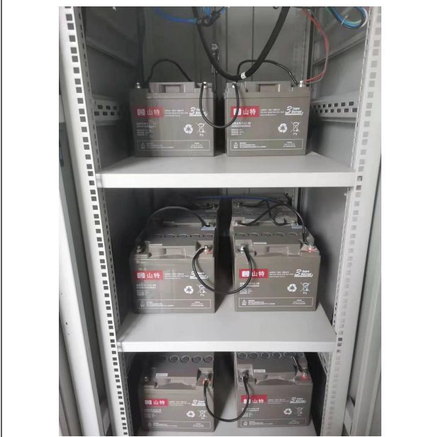
UPS 备用电源
