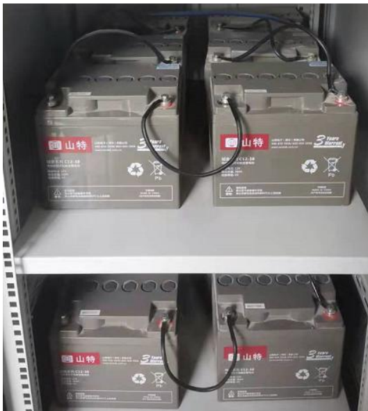
UPS 备用电源
