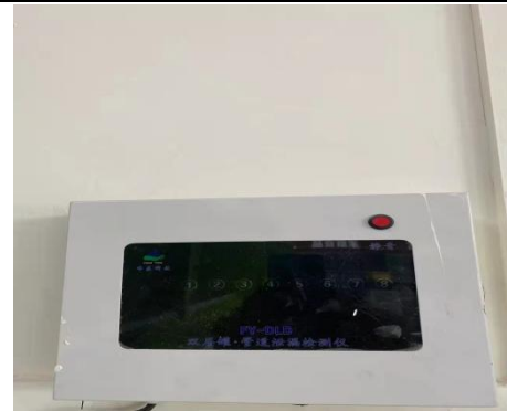
测漏报警系统
