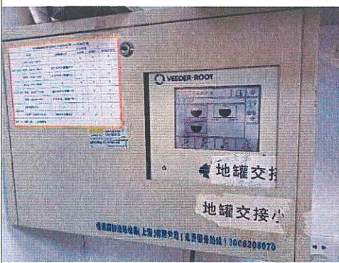
储罐液位显示器
