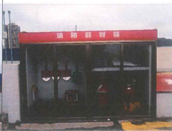
罐区消防器材
