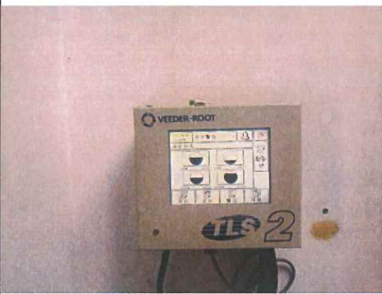
储罐液位显示器
