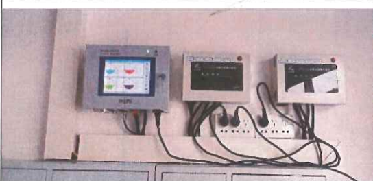
液位显示器及渗漏监测报警器
