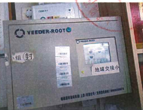
储罐液位显示器
