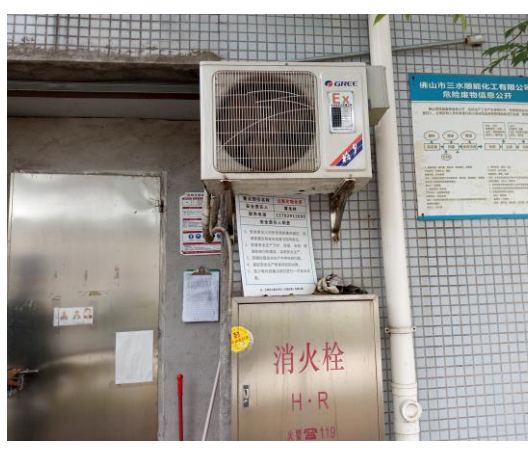
过氧化物仓库（设防爆空调）
