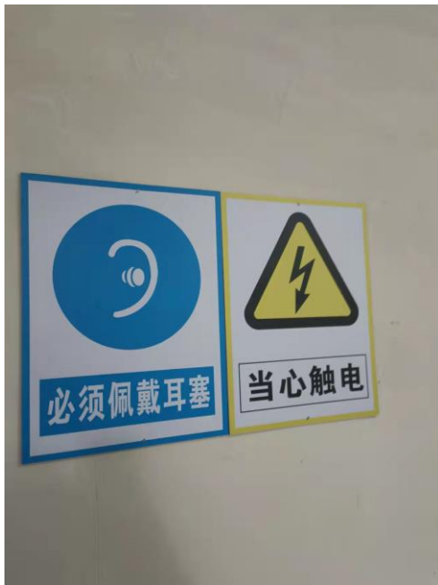
整改 1: 发电机房补充安全标志
