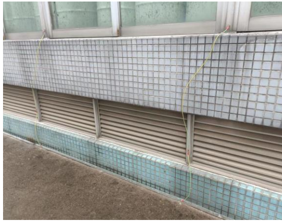
整改 3、6: 金属门窗接地
