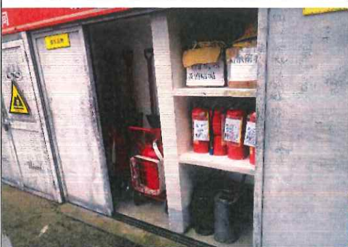
罐区消防器材
