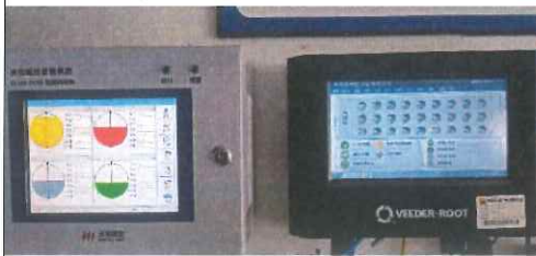
储罐液位显示器和在线渗漏监测显示器
