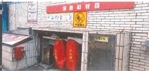
罐区消防器材及静电接地报警器
