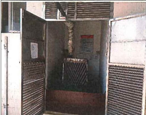
配电房和发电机房
