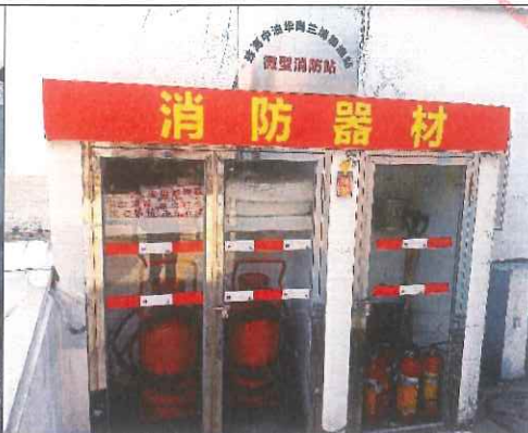
罐区消防器材
