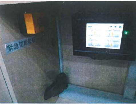
紧急切断按钮和液位显示仪
