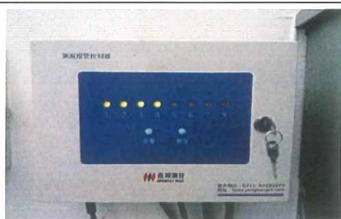
油罐测漏报警装置
