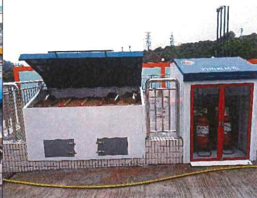
罐区消防器材
