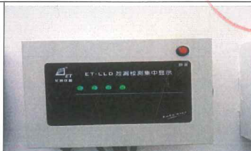
油管测漏报警装置
