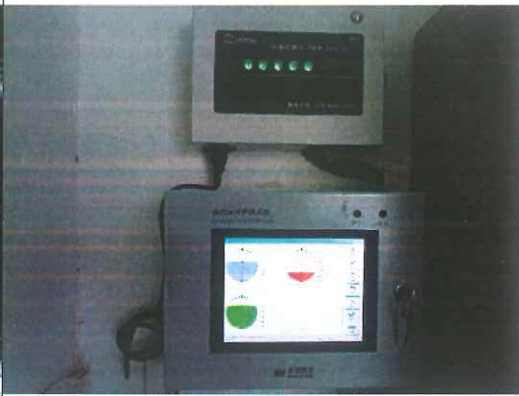
液位仪、油罐-油管渗漏在线监测仪
