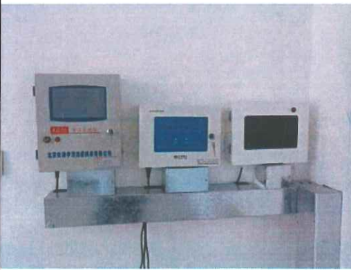
液位仪与油罐、油管在线渗漏监测系统
