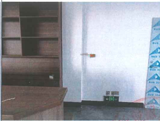
站房内紧急切断按钮
