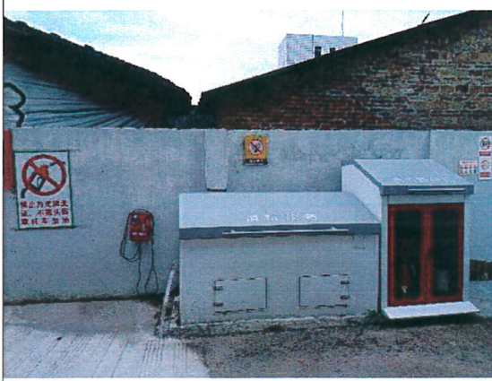
静电接地报警装置、消防沙、消防间
