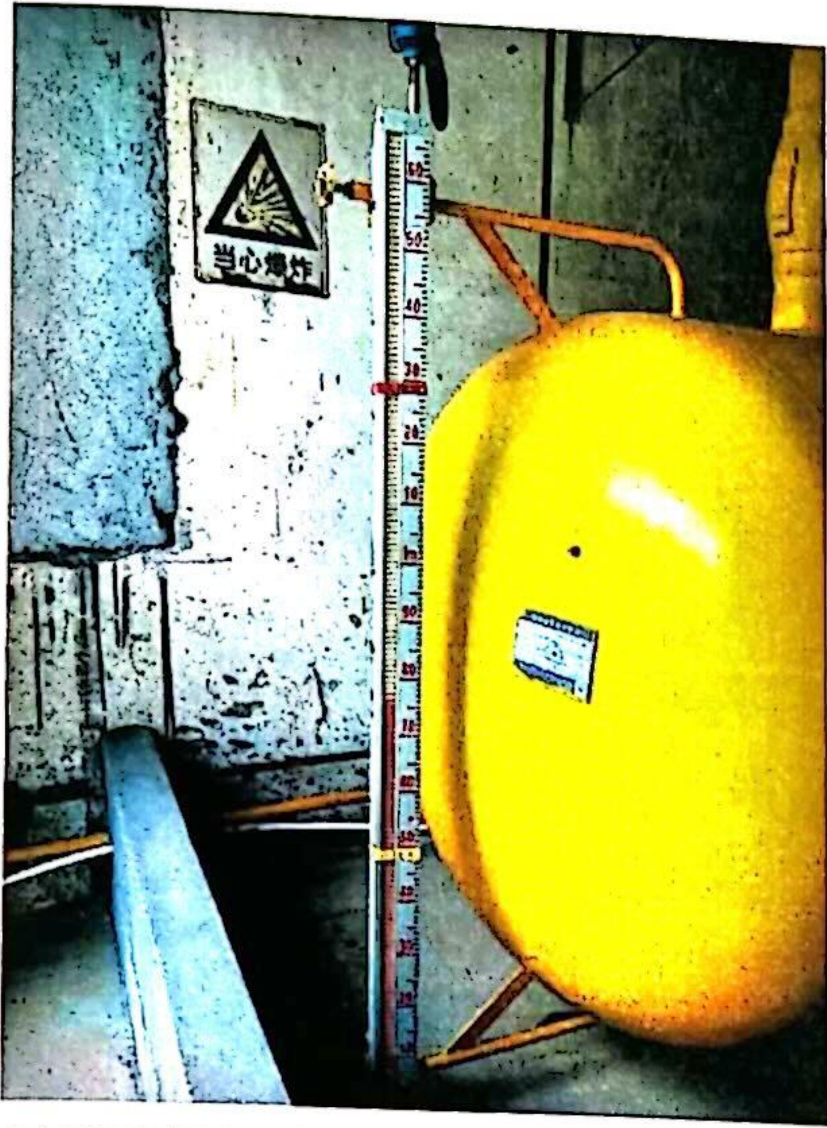
已明确标识液氨储罐高低位区域
