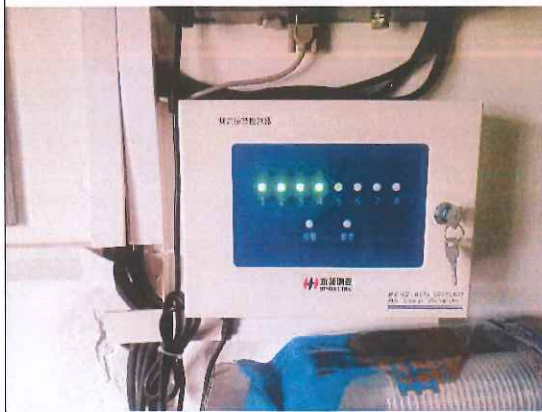
油罐渗漏在线监测
