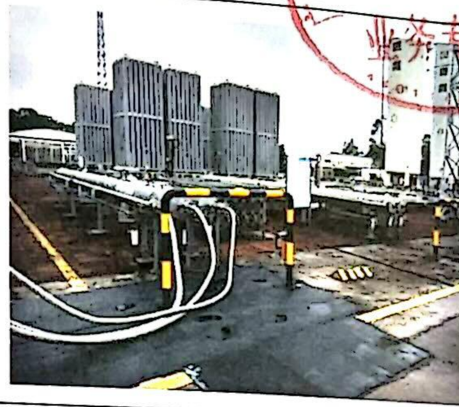
气化站卸车口
