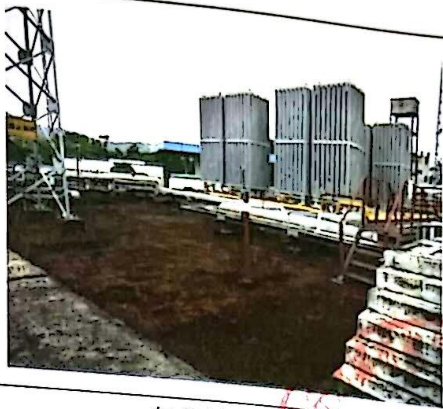
气化站气化区
