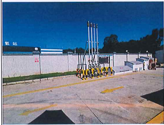
卸油区与通气管
