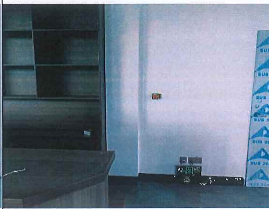
站房内紧急切断按钮
