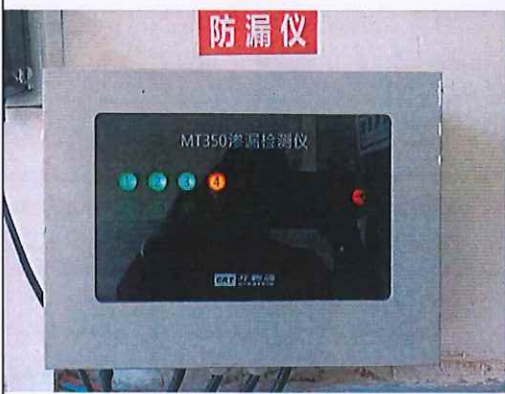
油罐在线渗漏监测系统
