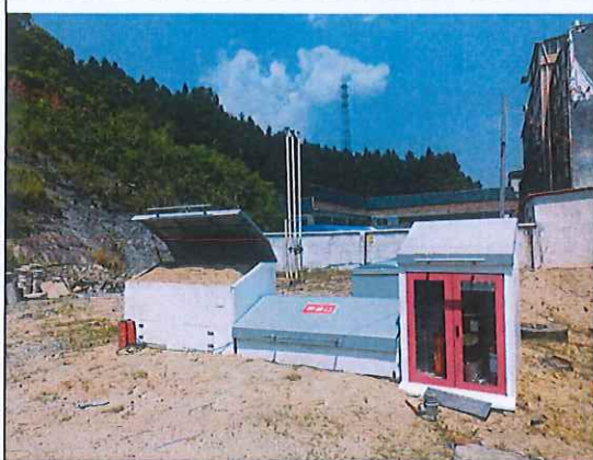
静电接地报警装置、消防沙、消防间
