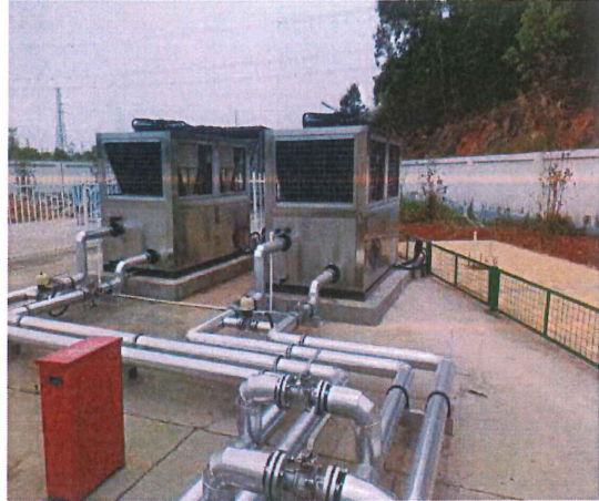
冷水机组管路
