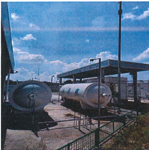
储气罐火焰探测器
