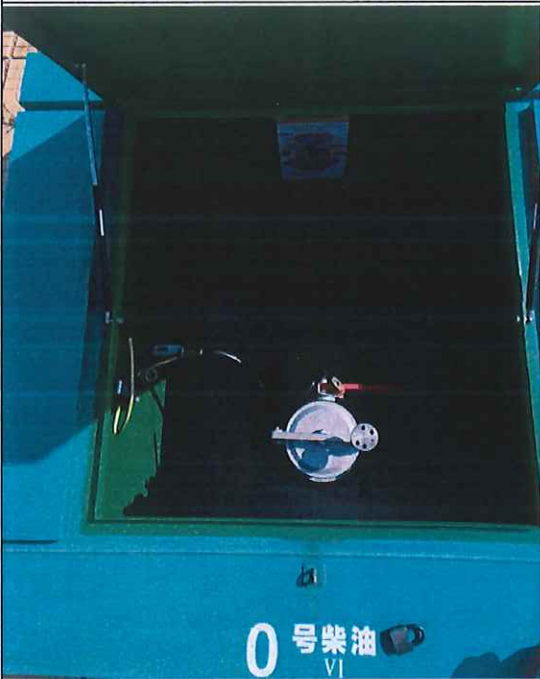
柴油罐操作井
