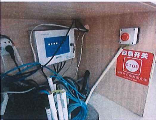
油罐、油管一体式在线渗漏监测系统 站房内紧急按钮
