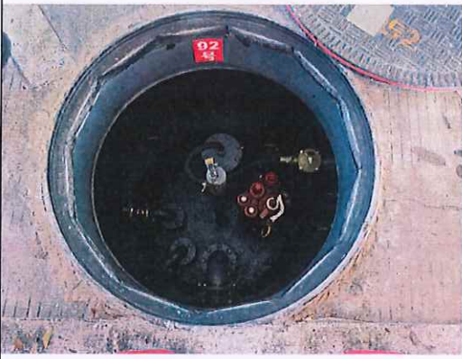
柴油罐操作井
