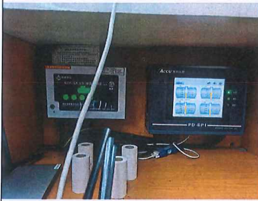
储罐渗漏在线监测、液位仪
