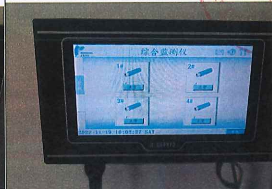
双层油管在线渗漏监测系统
