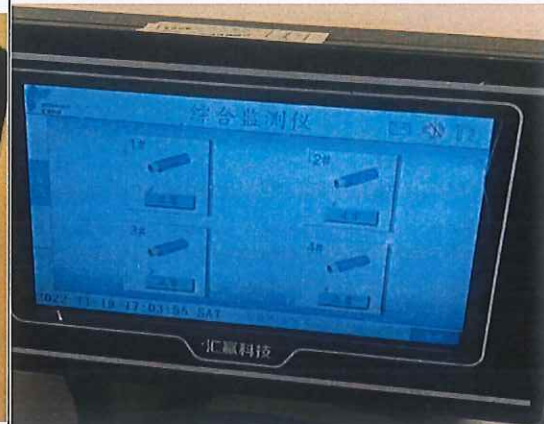
双层油管在线渗漏监测系统
