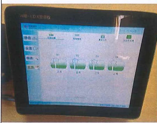
油罐在线渗漏监测系统
