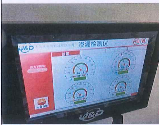
油罐在线泄漏监测系统
