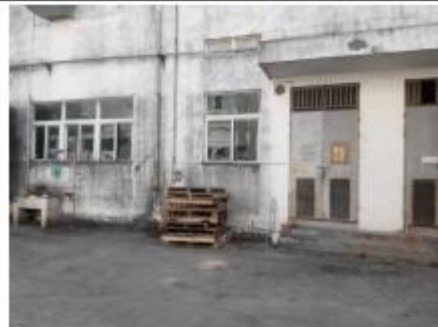
车间配电房等不在防爆区域内窗口未封堵
