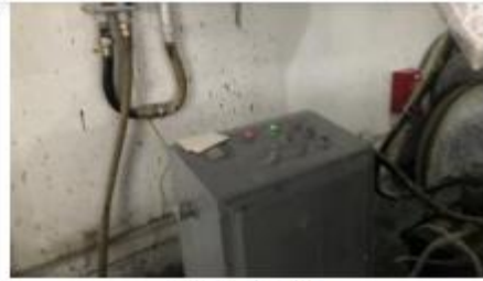
车间电气防爆
