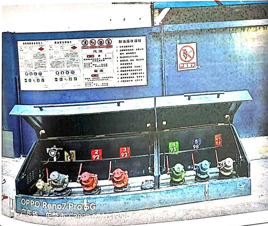
加油站卸油口照片照片
