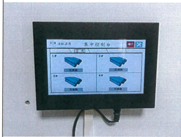
油罐—油管在线渗漏监测系统
