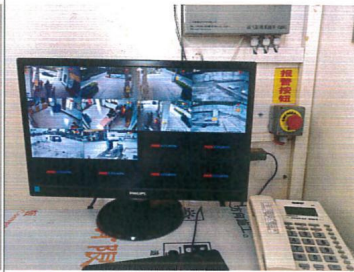
视频监控和站内紧急按钮
