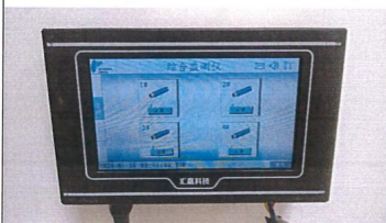
油管在线渗漏监测系统
