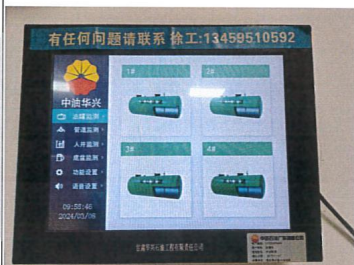
油罐在线渗漏监测系统
