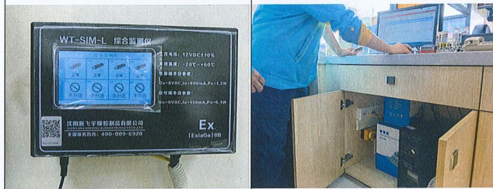
管道在线渗漏监测系统
