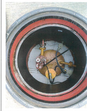
汽油罐操作井
