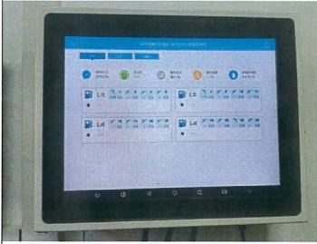
加油机油气回收在线监测装置
