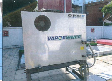
三次油气回收装置
