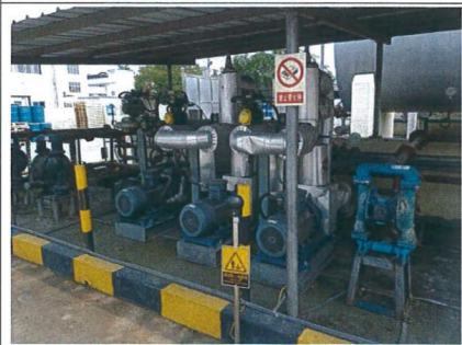
E3 储罐区泵区
