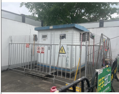
站内室外变压器
