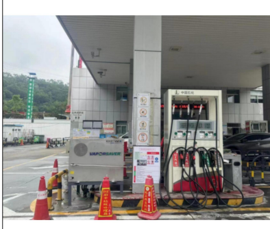
三次油气回收装置
