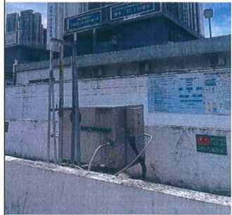
三次油气回收装置
