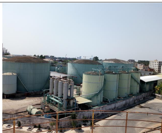
道维尔沥青停用的丙类装置、沥青储罐区
