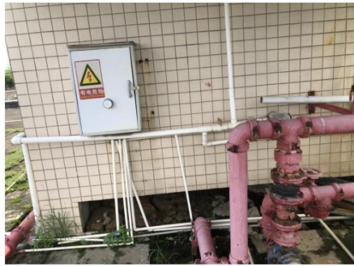
顶楼消防水池及水泵
