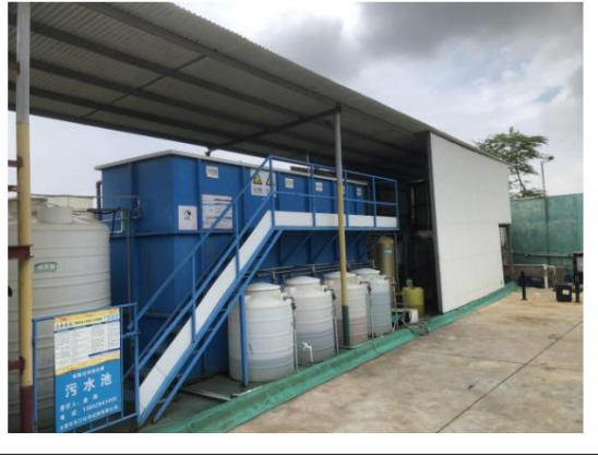
污水处理设施
