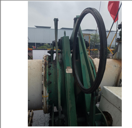
煤气管道盲板阀
