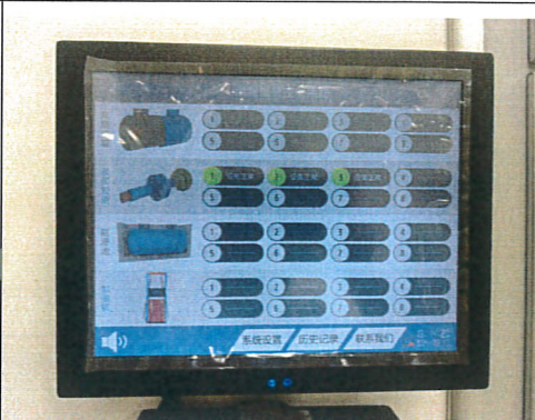
双层管道渗漏在线监测
