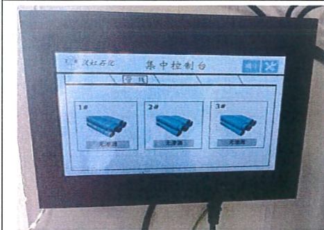
油管在线渗漏监测系统
